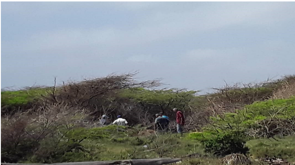
Existen fugas por rotura en varios sitios de la línea en el tramo comprendido desde La Encrucijada hasta la estación de bombeo de El Hato. Se requiere cuadrilla de obreros para realizar desmalezado y en algunos casos limpieza con retro excavadora.
