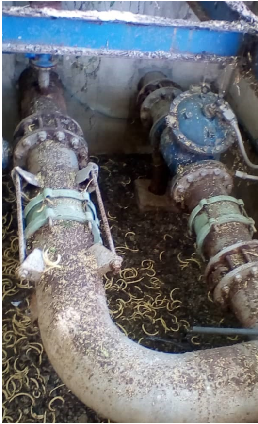
Instrumentos de control y medición deteriorados e inservibles (Adicora)
