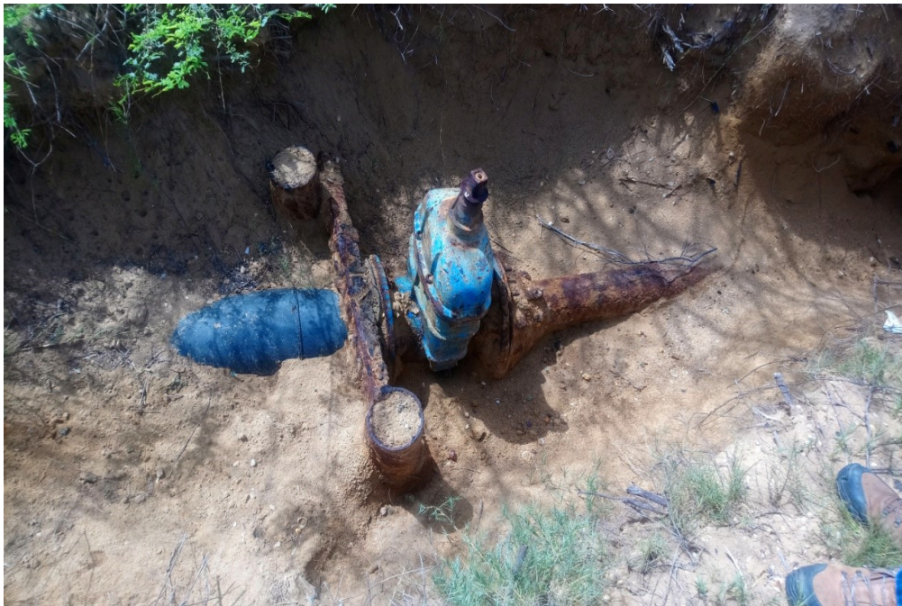
Válvula de 10" suministro hacia la población de Maquigua, amerita mantenimiento.
