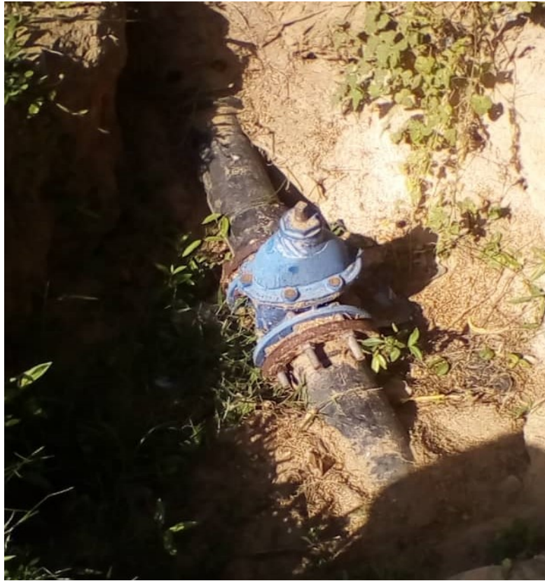
Válvula de suministro a la población del El Supi.
