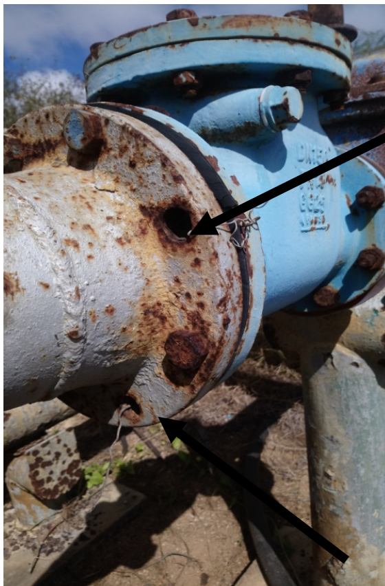
Bridas sin la tornillería completa.
