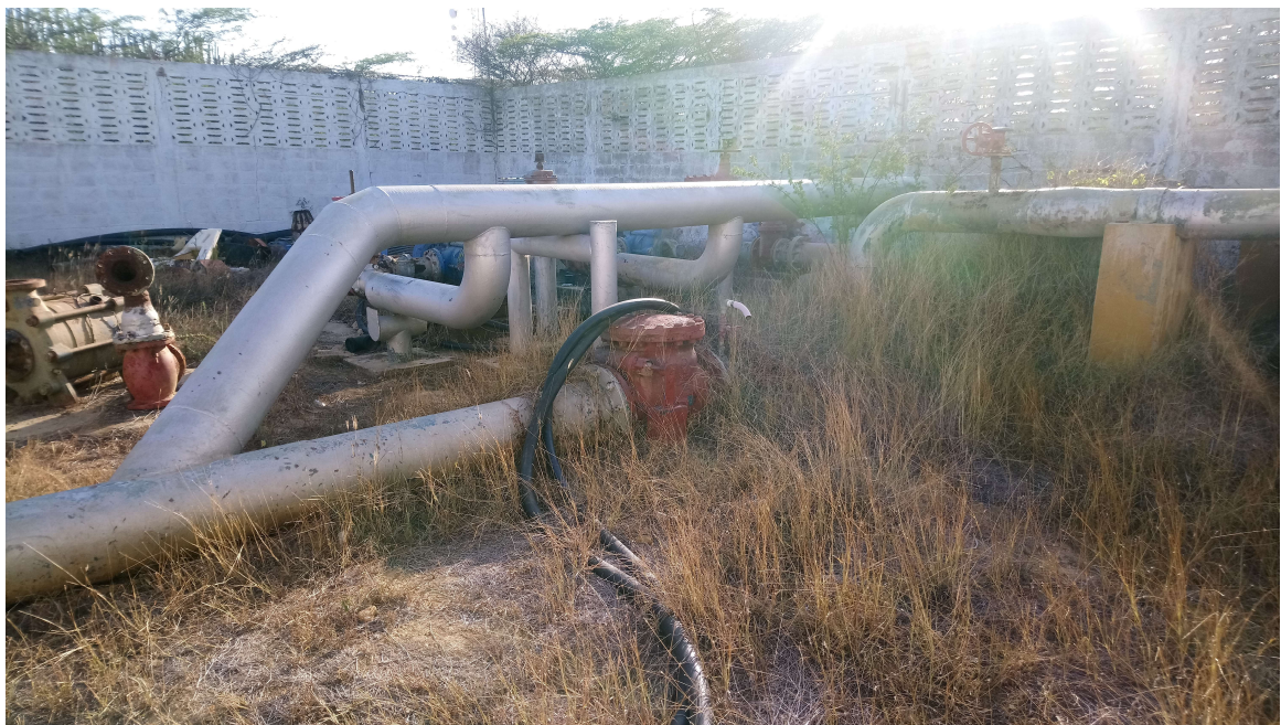
Válvula Check de 14", que debe ser reparada o reemplazada por daños internos, ya que no permite el pase directo desde estación de bombeo El Hato hacia Pueblo Nuevo.
