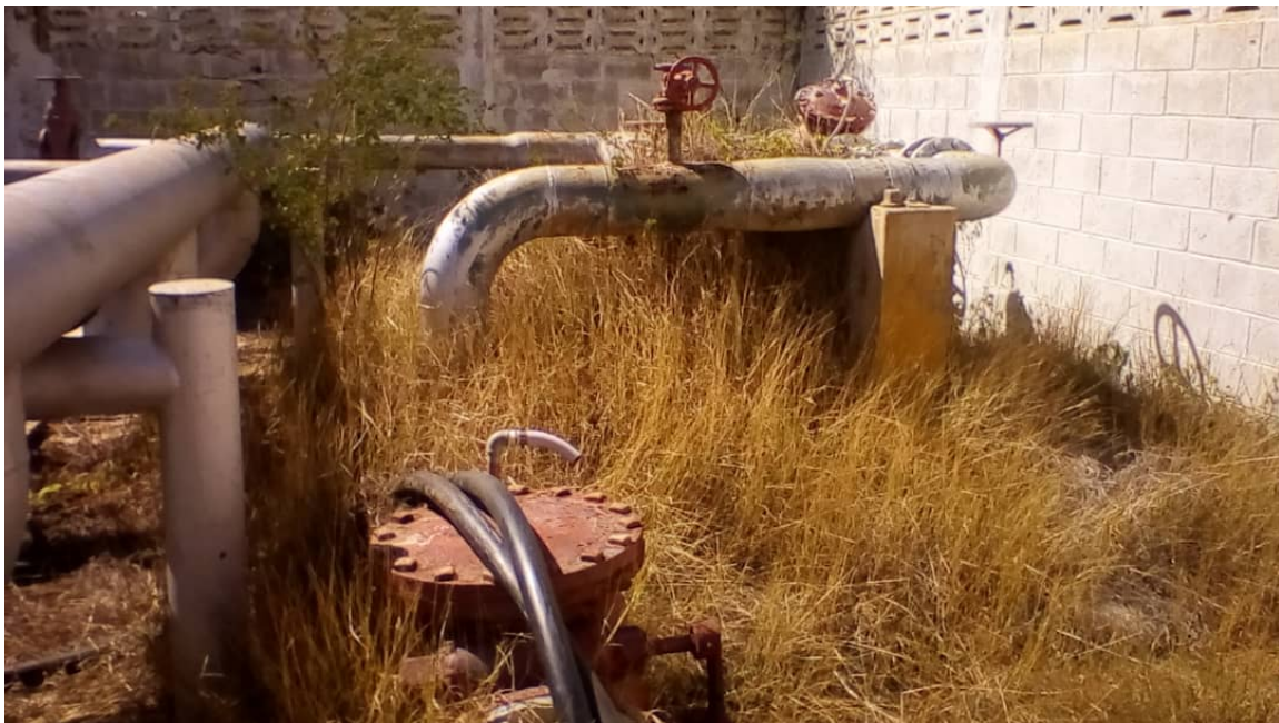
Válvula check de 14" que presenta daños internos y amerita ser reparada o reemplazada.
