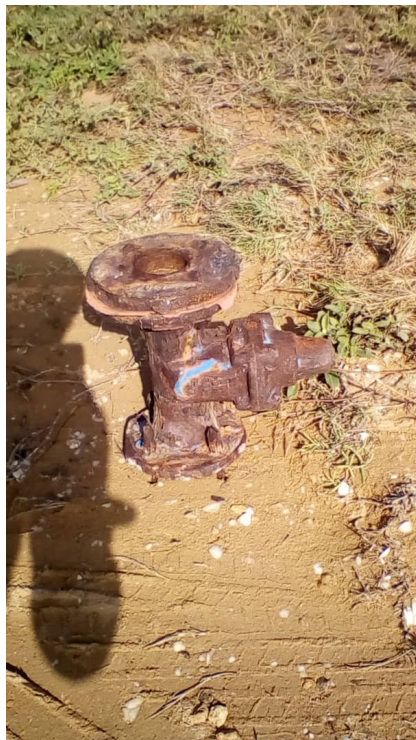
Válvula desmontada e inservible
