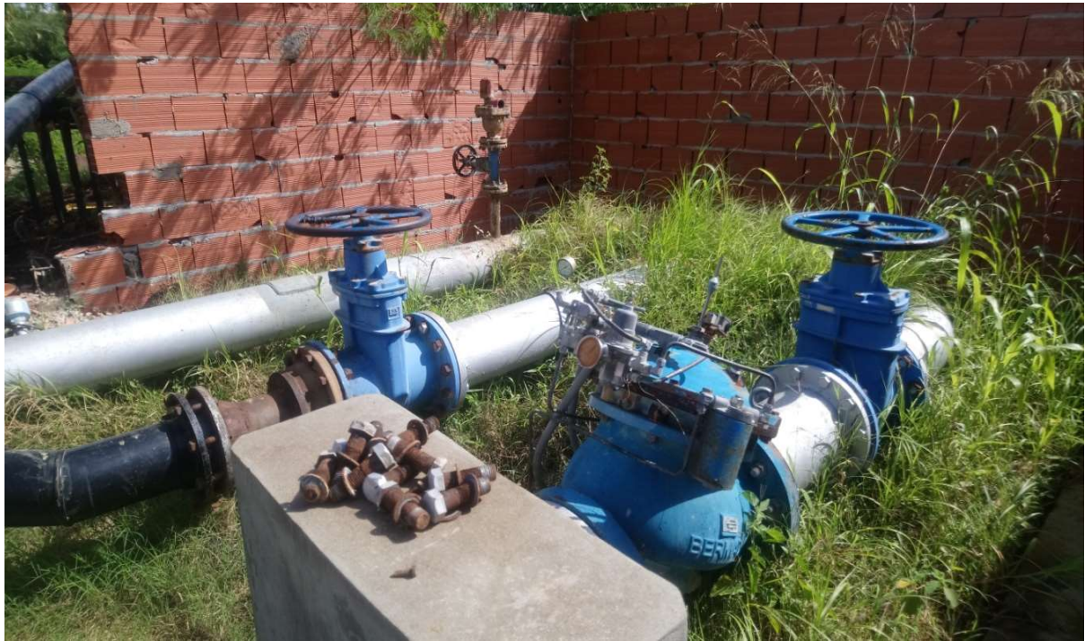
Zona de conexión del By Pass
