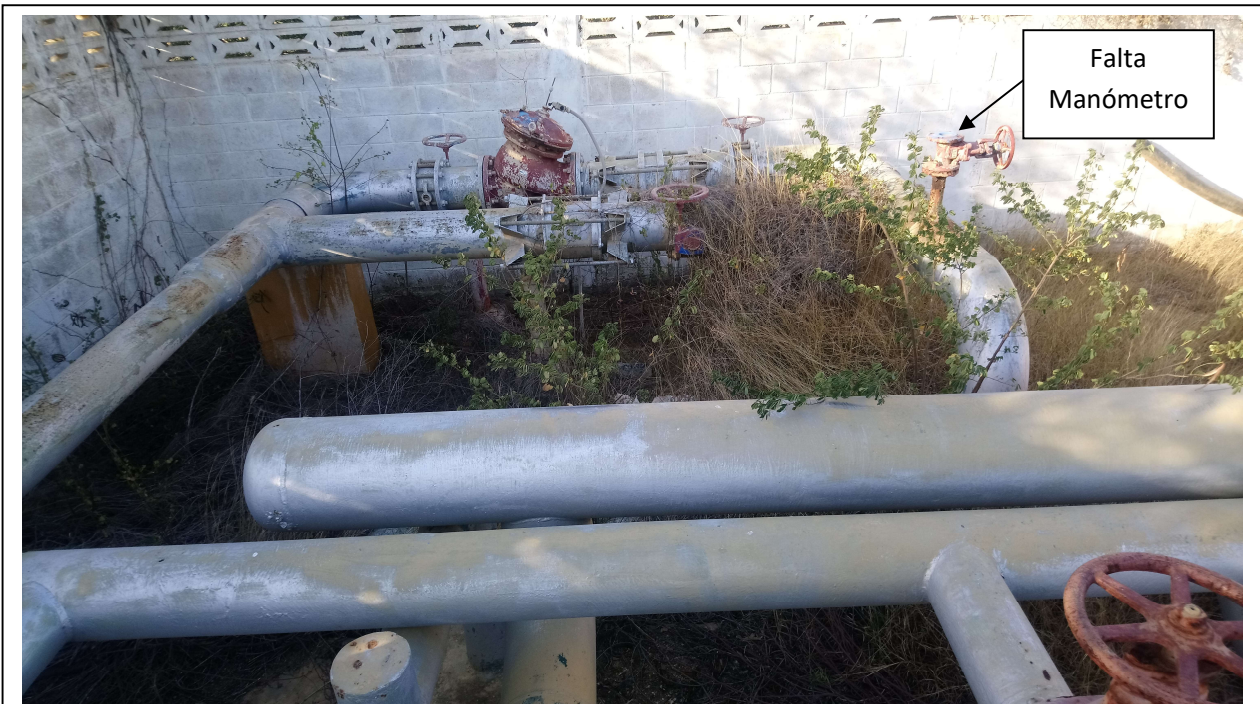
Válvula de control de presión debe realizarse mantenimiento.
