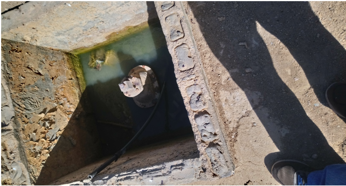
Válvula de drenaje del tanque (presenta fugas)
