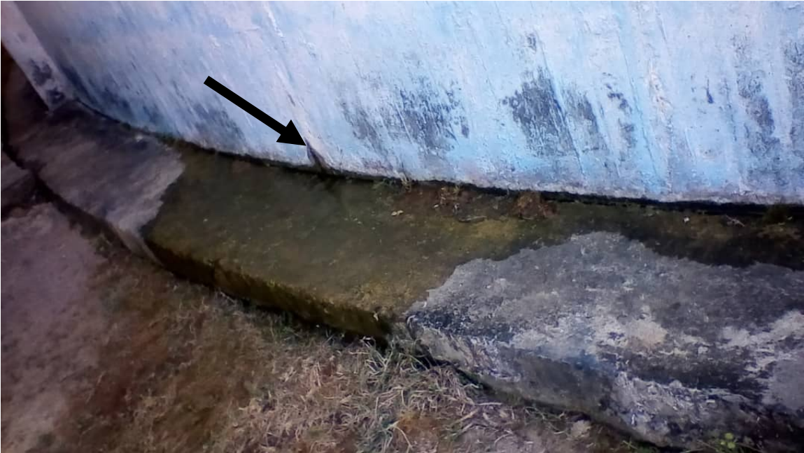
Filtraciones en la pared del tanque.
