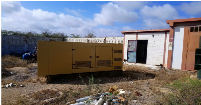
Generador eléctrico no operativo por fallas.
