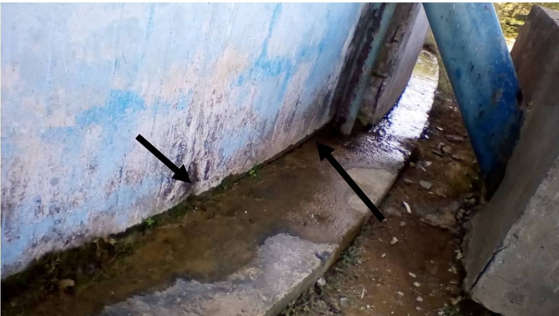
Filtraciones tanto en la pared como en el piso del tanque.
