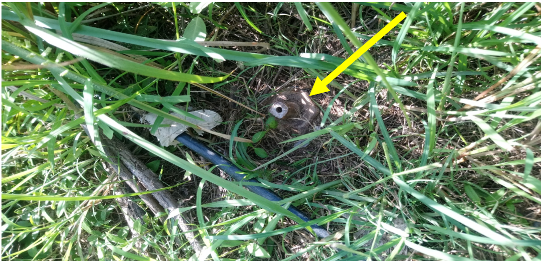
Válvulas sin ningún tipo de protección
