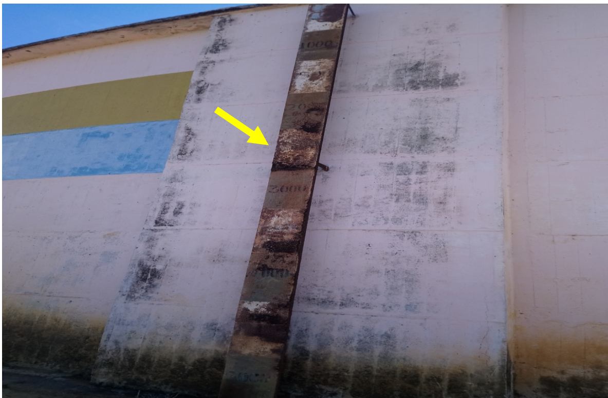
Daños severos en el sistema de medición de niveles de agua en tanque.
