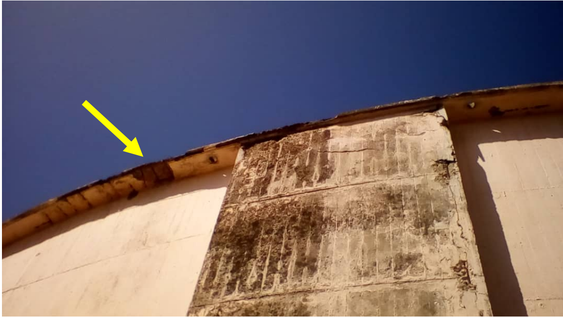
Fallas de borde en concreto de techo del tanque, refuerzo metálico expuesto.
