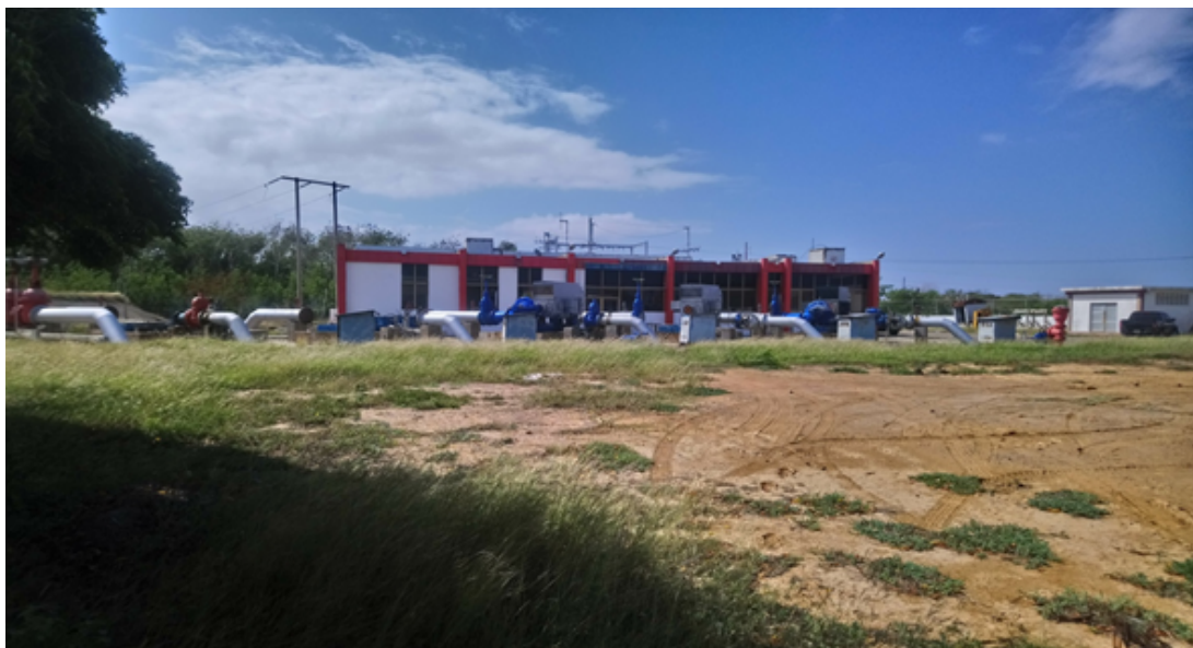
Sala de control para arranque y parada de los equipos. Por diseño debe tener cinco (05) bombas para garantizar el bombeo permanente hacia los tres (03) Municipios de La Península. En teoría deben estar en servicio 3 bombas y 2 disponibles. Adicionalmente la gráfica muestra el terreno donde está planificado iniciar los trabajos para la instalación de una estación de bombeo con tres equipos.
