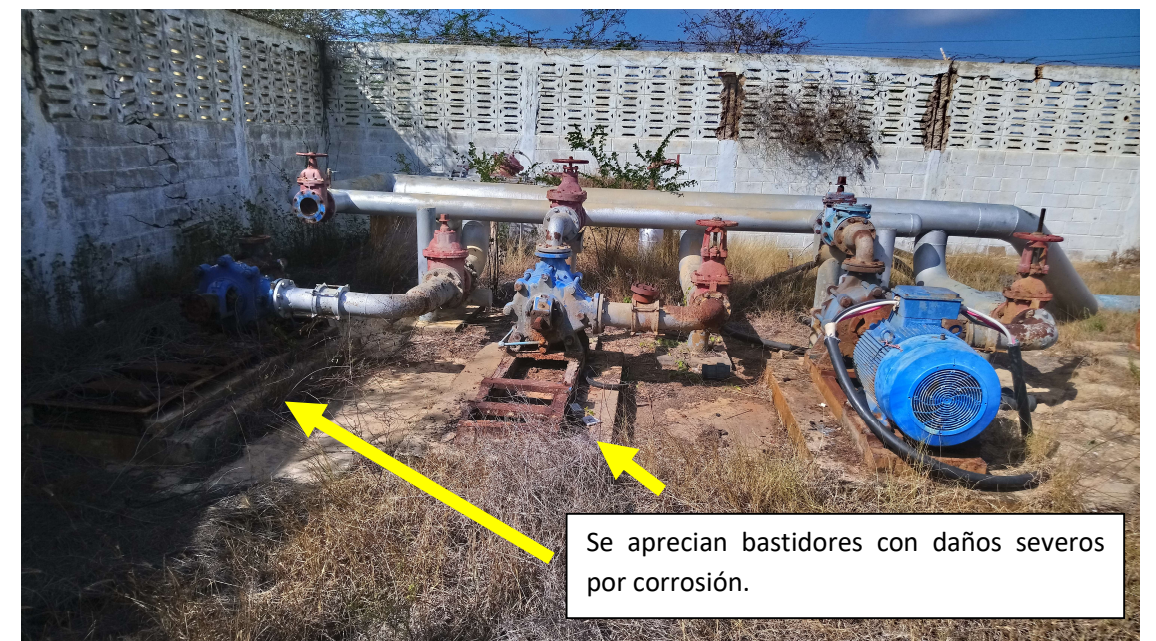
Se aprecian las tres (03) bombas y solamente una (01) con su motor.
