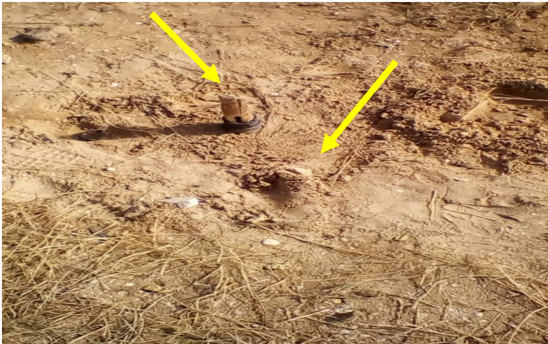
Sitios donde deben estar instaladas válvulas de seguridad convertidas en puntos de llenado para cisternas.
