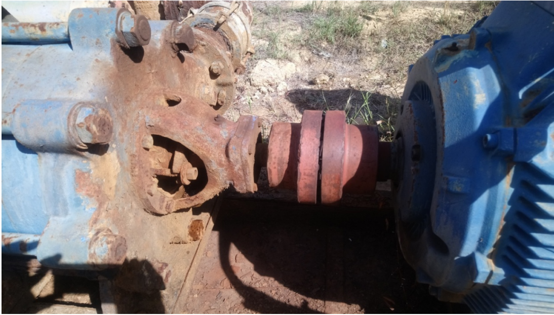
Equipo disponible (motor y bomba) presenta un des alineamiento severo que ocasiona daños en ambos equipos.
