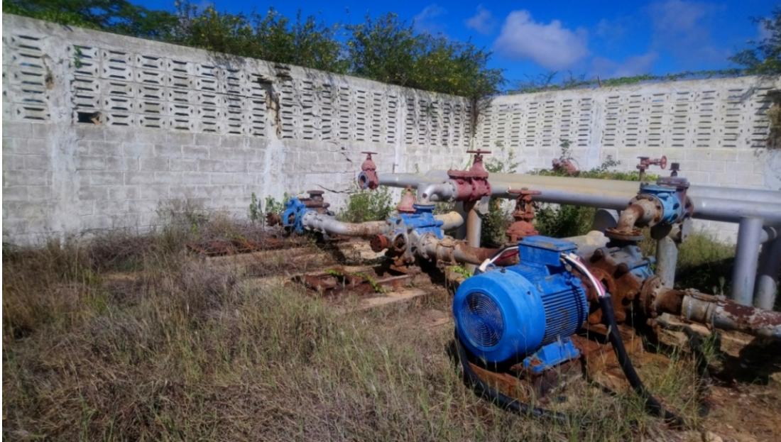
Estación de Bombeo de Guacaira Arriba ubicada al este de Pueblo Nuevo Vía Adicora en los actuales momentos tiene tres (3) bombas instaladas y una cuarta (4) que está en el área parcialmente desmantelada, solamente hay un equipo completo con motor disponible el resto de motores fueron removidos para ser reparados sin que hayan finalizado sus reparaciones.
